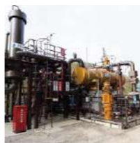
温泉バイナリー発電所
